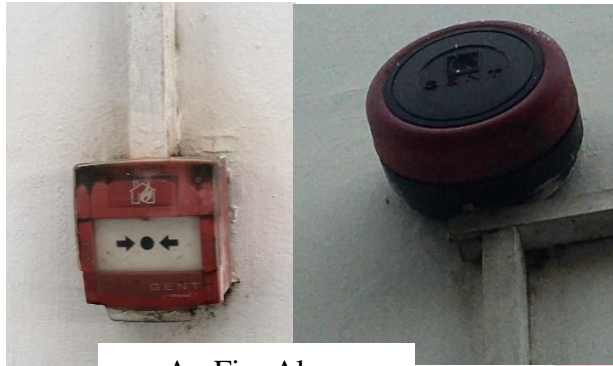
A. Fire Alarm
